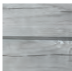
Rysy, pęknięcia / Scratches and cracks
