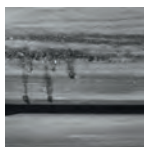
Wycieki żywiczne / Resin leaks
