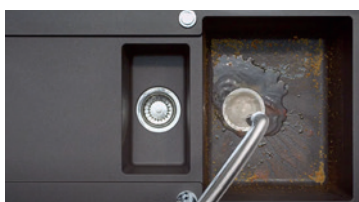
bardzo silne zabrudzenia
