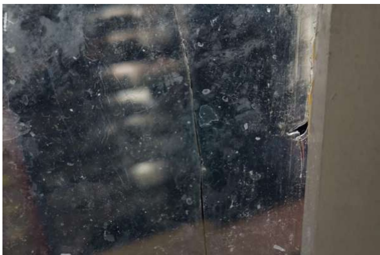
Ekstremalny przypadek uszkodzenia folii FEP
